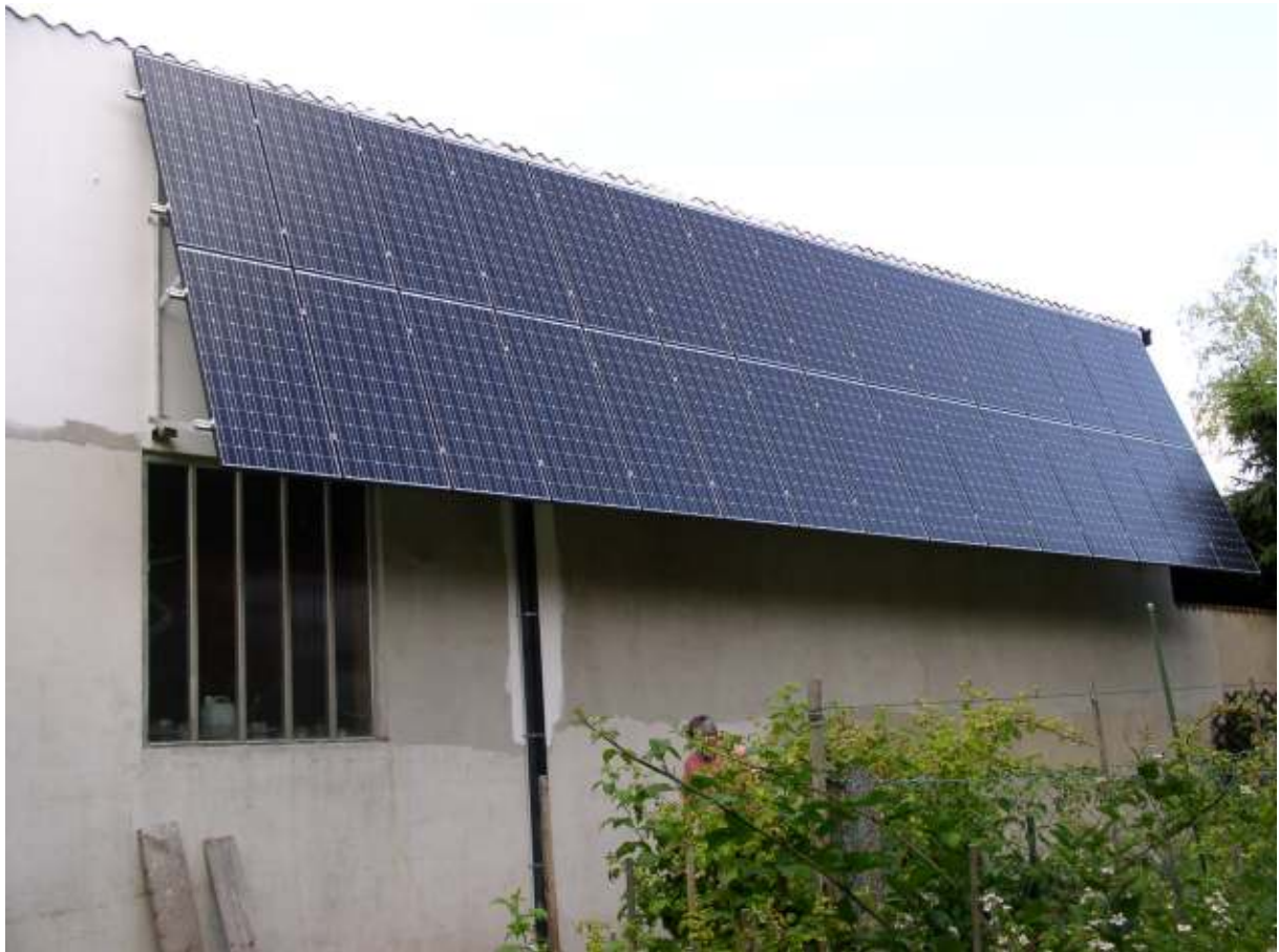
Netzverbundanlage Fassaden-Aufständerung, 5,74kWp Module Typ Sanyo HIP205NHE-1
