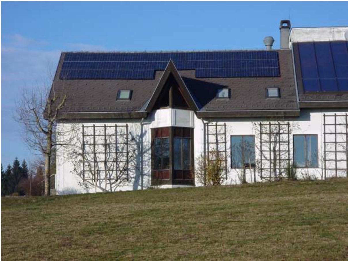
Netzverbundanlage Aufdach, 12,25kWp Module Typ Kyocera KC125GHT-2
