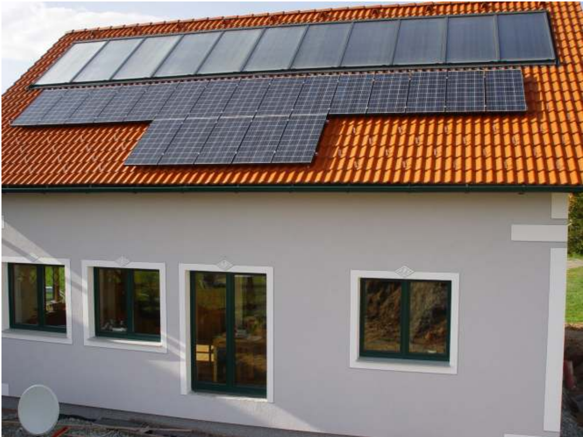
Netzverbundanlage Aufdach, 2,05kWp Module Typ Kyocera KC125GHT-2
