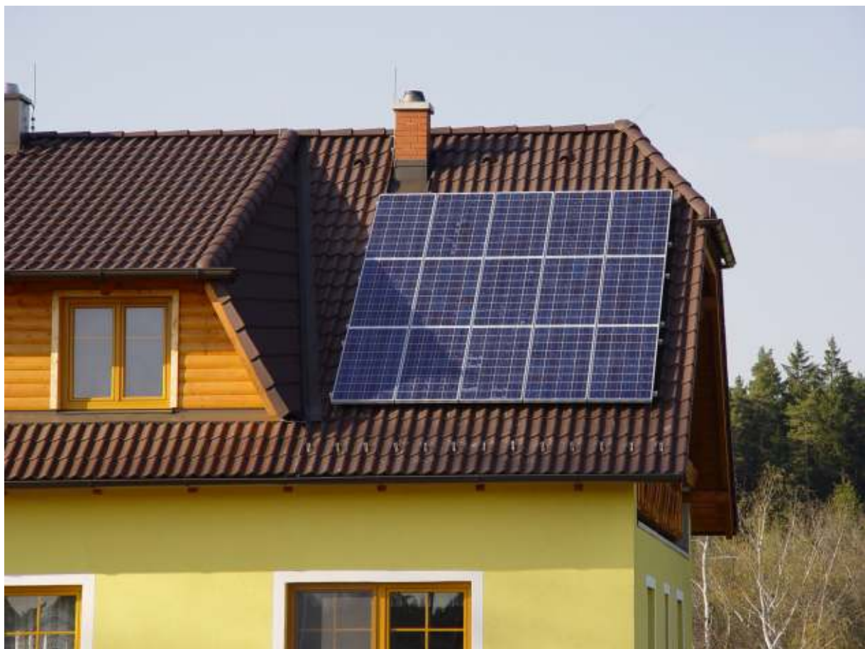
Netzinselanlage Aufdach, 1,8kWp
