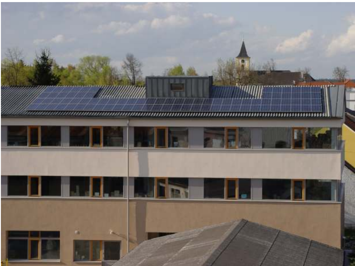
Netzverbundanlage Aufdach, 10,08kWp Module Typ Kyocera KC125GHT-2
